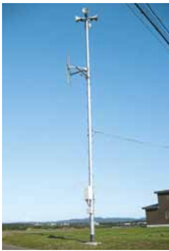
防災行政無線を利用した屋外スピーカー
